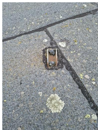
Dålig och gammal tätning vid infästning
