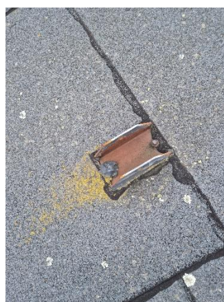
Dålig och gammal tätning vid infästning
