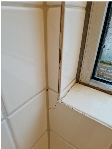
Skadad platta och sliten fog
