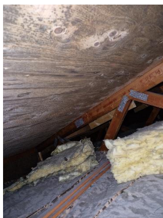
Mögel och högt fuktighet på yttertak
