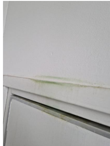
Påväxt på dörrkarm
