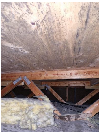
Mögel och högt fuktighet på yttertak
