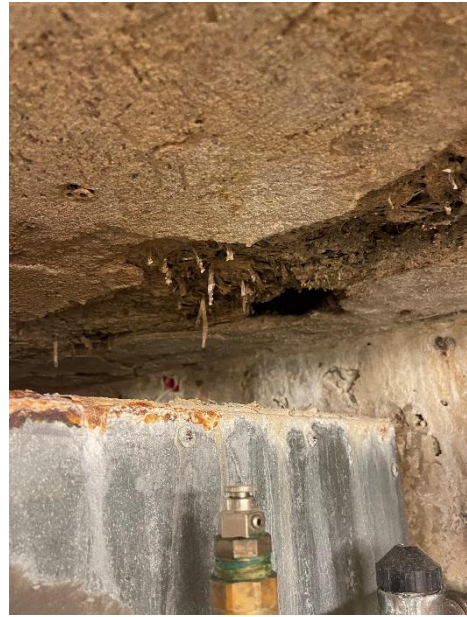
Spjälkning och sprickor
