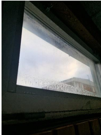
Kondens invändigt och mellan glas
